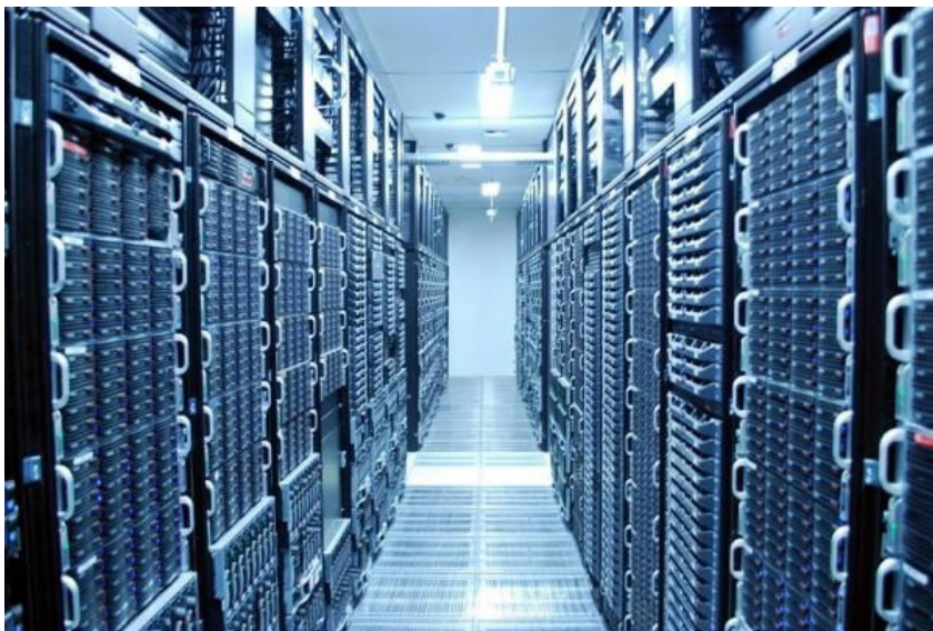
Figura 7.1: Datacenter da Locaweb. Fonte: http://www.tecmundo.com.br/servidor/41528-fortaleza-tecnologica-visitamos-o-datacenter-da-locaweb.htm
